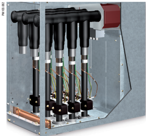
Ячейка шириной 450 мм, присоединение кабелей на токи до 800 А
