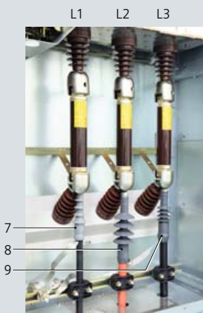
Кабельный отсек с кабельными концевыми муфтами (Опции: А 2) , см. далее)
