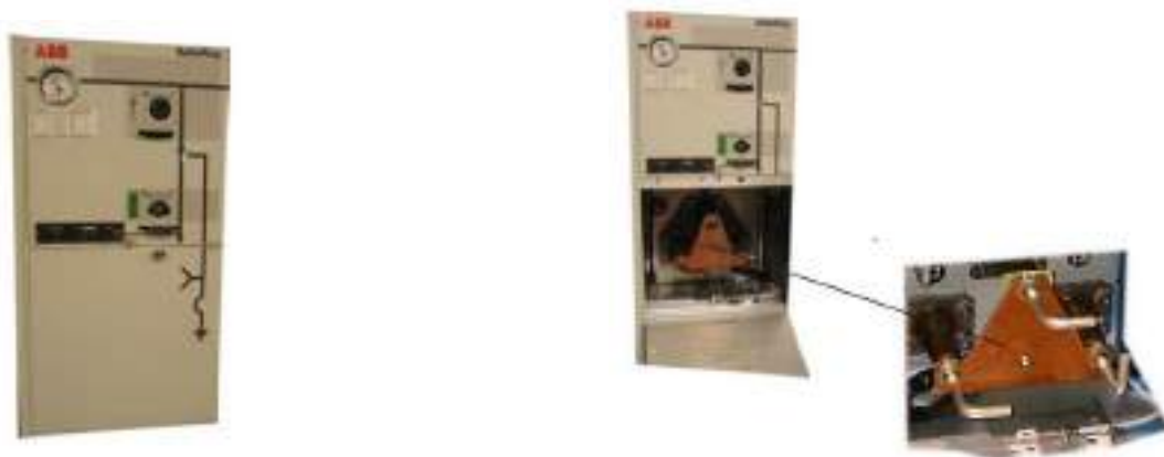
Рис. 14. Вид на отсек с втулками для испытания кабелей.
